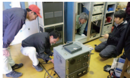
図 3 臨時に無線機を設置（その 1）
